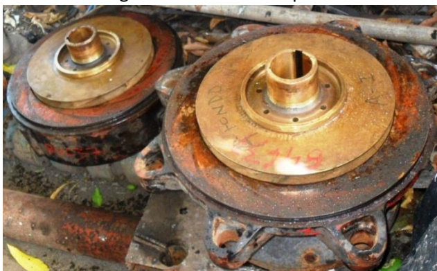
Foto 6: Impulsos de bombas de estación de Cocibolca
