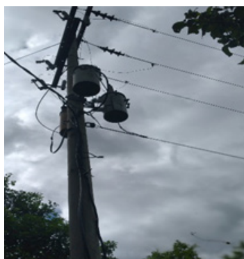
Foto No. 1 Energía pozo existente
