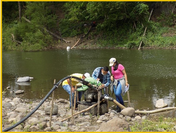
Foto 21: Bombas instaladas de forma temporal, sitio El Guayabo viejo, Somoto
