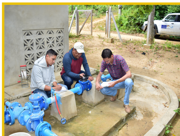
Foto 5: Pozo perforado bombeo eléctrico, casco urbano Santa María
