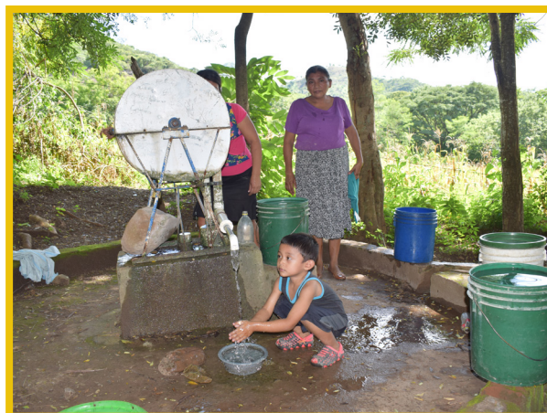
Foto 6: Pozo perforado con bomba de mecate en Unile, Somoto
